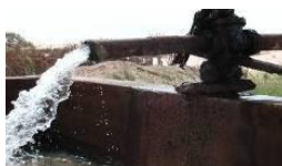
Forage captant nappe du CT
