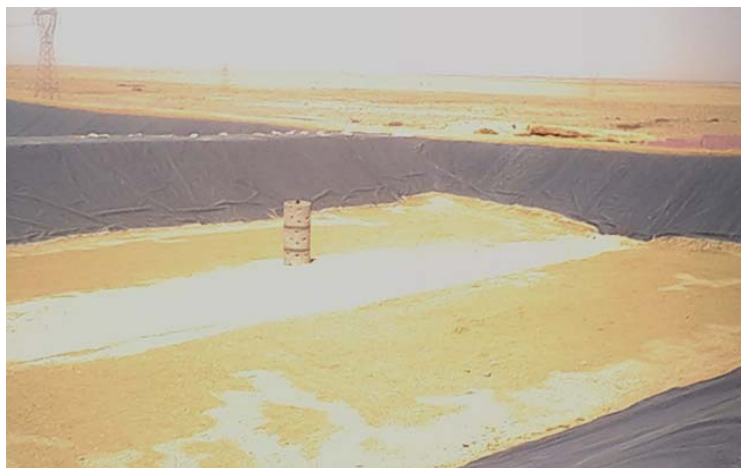
Cette photo montre les Casiers ou fosses de 6 à 9 mètres de profondeur tapissés par un film en PEHD avec petite colonne perforée permettant l'évacuation des gaz issus de la fermentation anaérobie.
